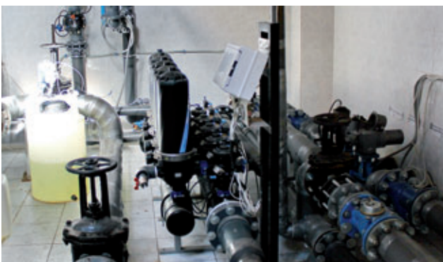
RUSIA RUSSIA | Eliminación de hierro en el agua The station iron removal of water
